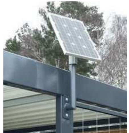
▲ Solarmodul an Warthehallenstütze befestigt
