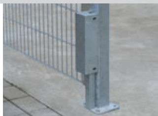
▲ Detail: Anschlusskasten mit Blechummantelung, feuerverzinkt
