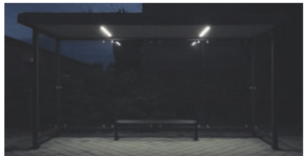
▲ Deckenverkleidung mit LED-Beleuchtung am Beispiel der Wartehalle STADT
