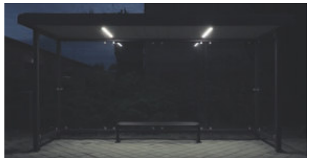
▲ Deckenverkleidung mit LED-Beleuchtung
