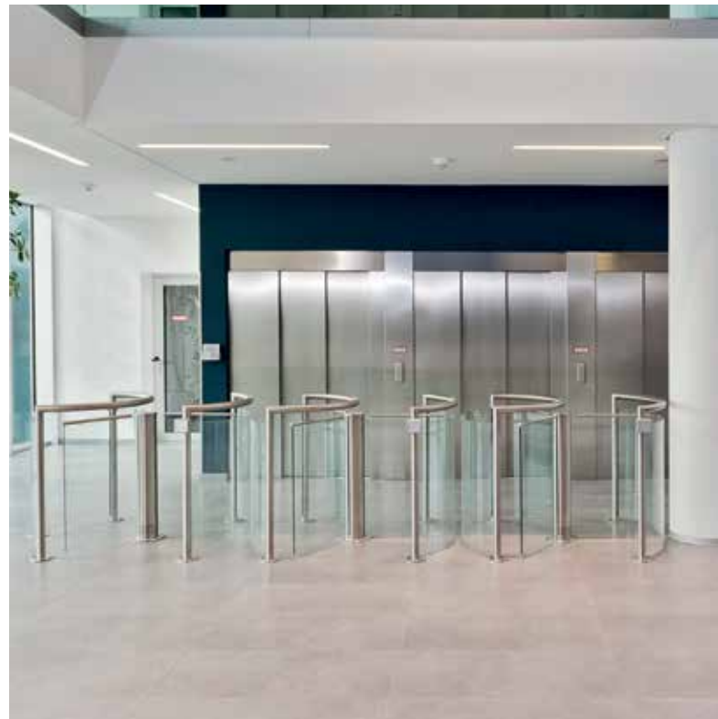
Absicherung vor dem Aufzug
