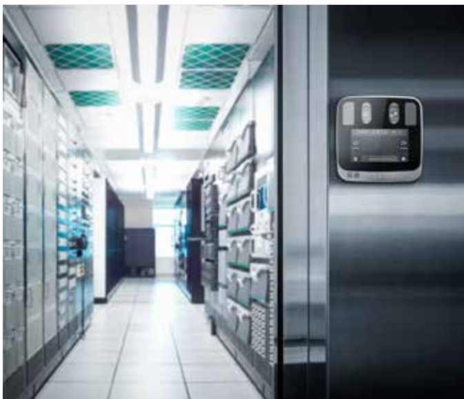
Online-Zutrittskontrolle z.B. für IT-Räumlichkeiten
