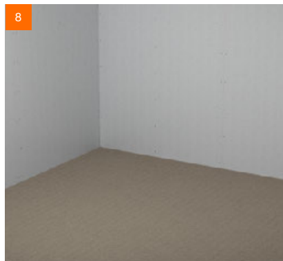
8 Nach dem selben Prinzip wird die gesamte Fläche mit fermacell™ Gebundener Schüttung T versehen
