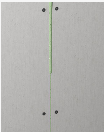
Teilweise entfernter Fugenkleber
