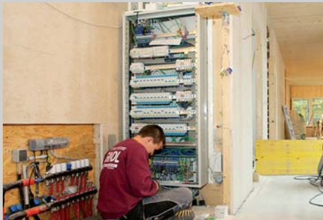
Anschluss des E-Verteilers
