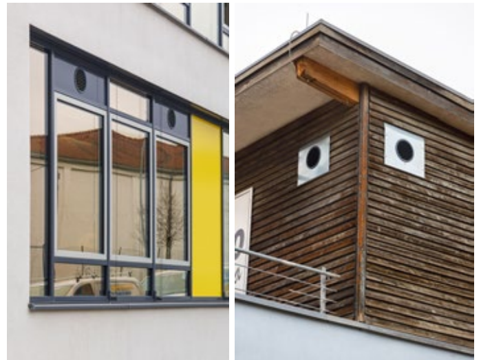
Fortuftauslässe und Außenlufteringänge befinden sich in den Oberlichtern der Fenster bzw. über Eck an der Außenwand
