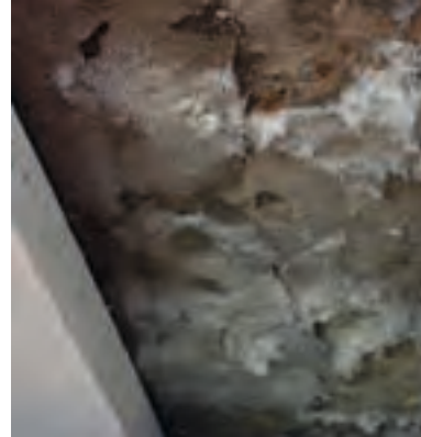
Beispiel für oberflächliche Ausblühungen
