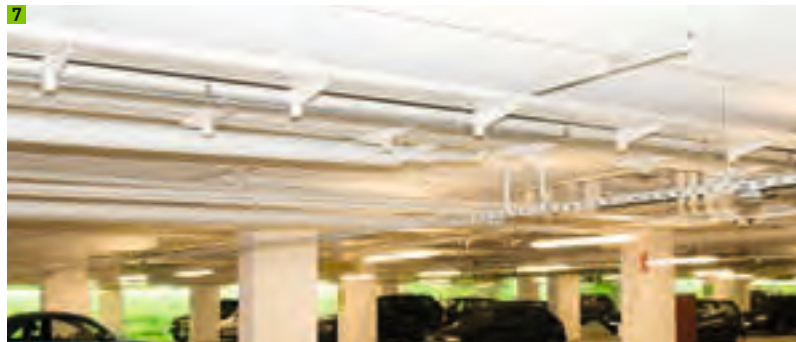
Befestigung einer Sprinkleranlage
