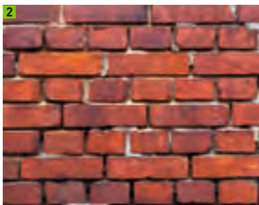
Klinkerfassade – Sanierung notwendig
