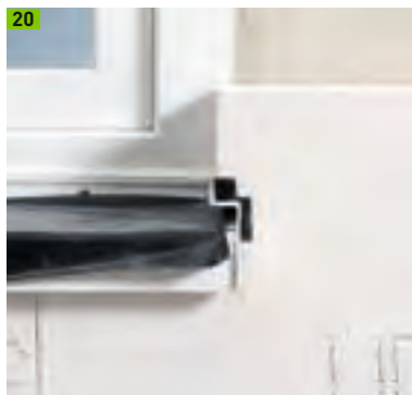
Fugendichtband an Fensterbank
