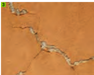
rissiger Putz – Sanierung notwendig
