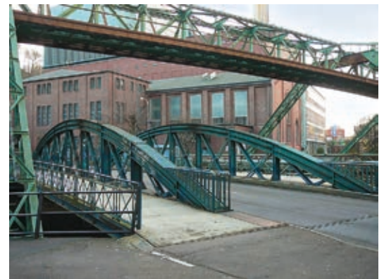
02 Renovierungsbedürftig: die 1899 errichtete Brücke „Kabelstraße“ in Wuppertal.
