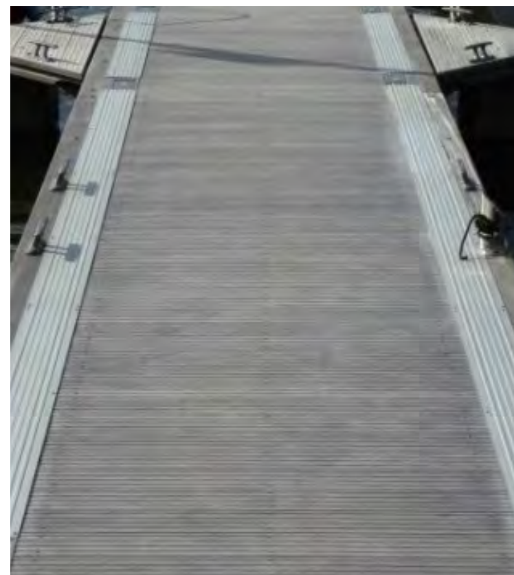
VERWITTERTES UNBESCHICHTETES ACCOYA
